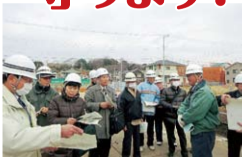
飯山満川整備工事視察。住民のみなさんと県や市に水害対策推進を要望しています。
