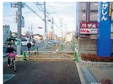
▲成田街道、前原東・夢庵前。歩道の整備を求め丸山県議とともに繰り返し県と交渉。現在、工事が行われています。
