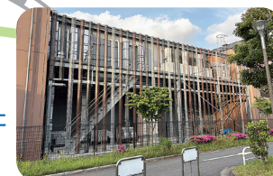
ららテラス室外機
